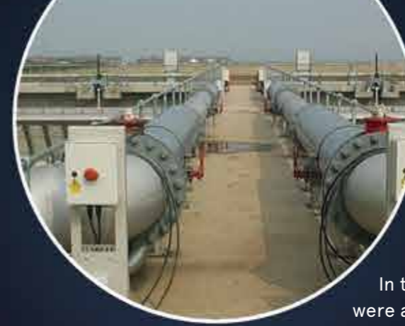
Markse WwTW, UK 140,000 PE
